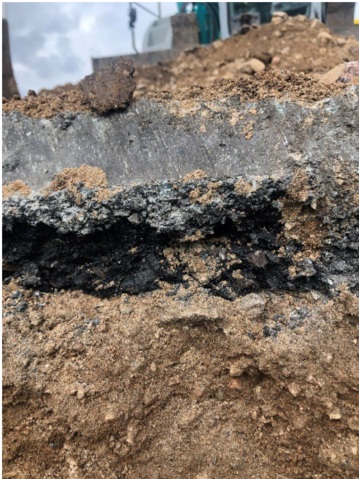
Figur 3. Dubbla lager asfalt i provpunkt 2203, med misstänkt tjärasfalt i underliggande lager.
